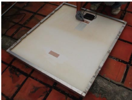
▲圖三 澎湖太陽光電系統模組鋁框電位腐蝕
