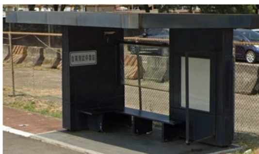
▲圖二 老舊損壞候車亭
