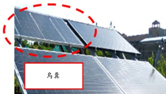
▲圖十五 候鳥棲息地太陽光電模組受到鳥糞侵害
