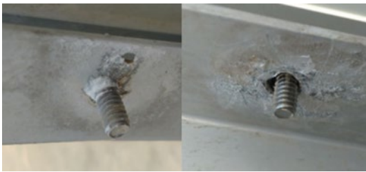
▲圖十七 白鐵螺絲與太陽能模組鋁框產生伽凡尼腐蝕
