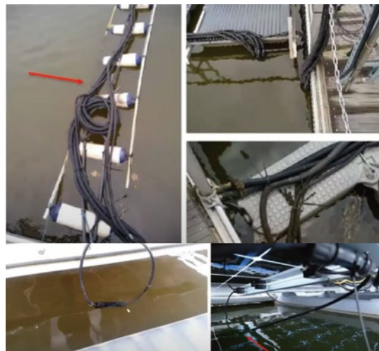
▲圖十六 浮動型太陽光電系統電纜固定設計不良 (14)
